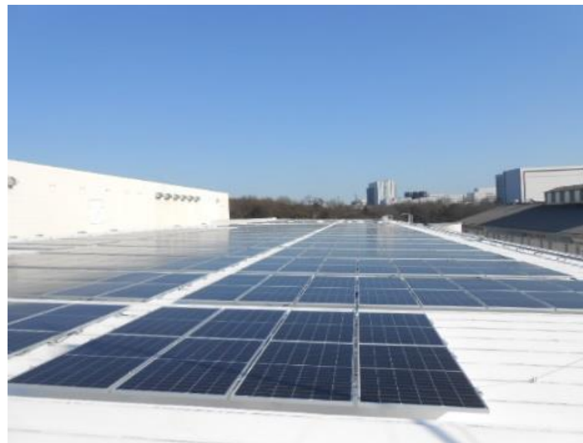
西神第2工場屋上(2021年2月～)
