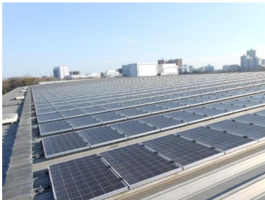
西神第1工場屋上(2014年6月～)
