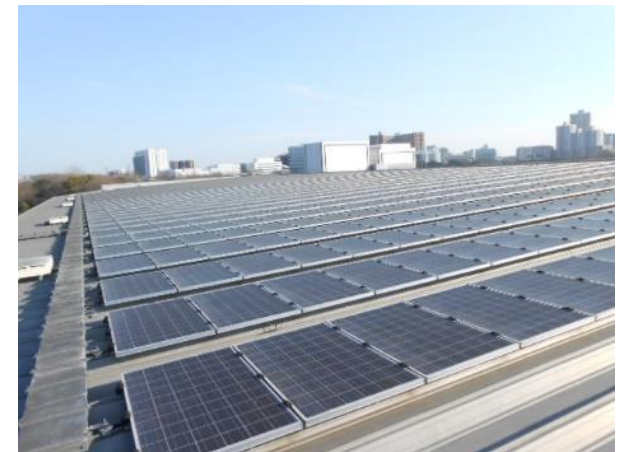
西神工場屋上 太陽光パネル
